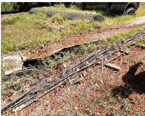
Foto 3: VARILLAS A LA INTEMPERIE
