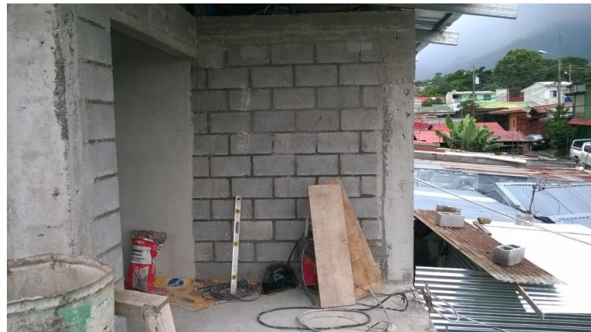
Foto N° 6: Construcción con cambios de diseño.
