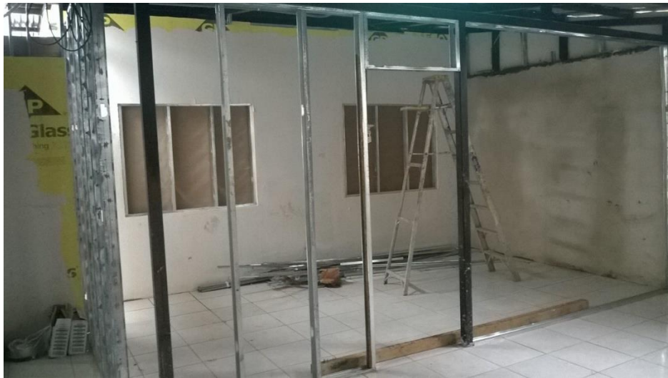
Foto N° 1: Ventanas sin ventilación
